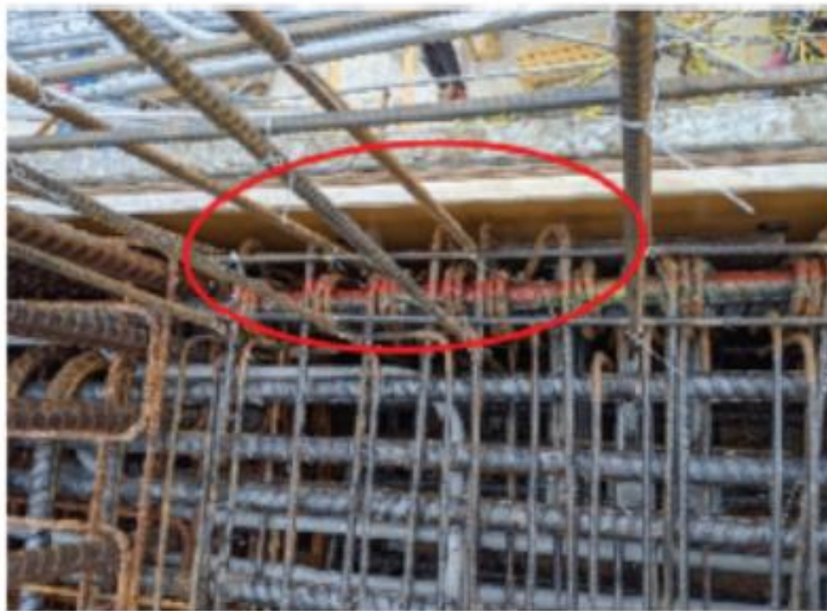
圖 1.2 梁與柱邊緣齊之梁主筋彎折後， 梁箍筋 135° 彎鉤端無法緊貼主筋。
